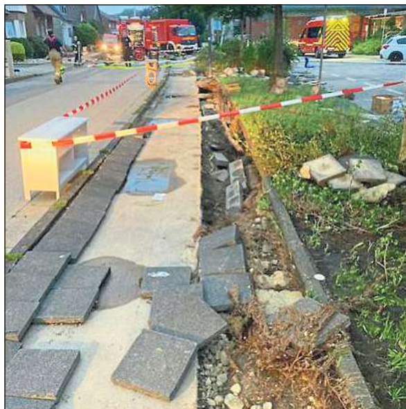
Bürgersteigplatten einfach weggerissen: die Kraft des Wassers.
